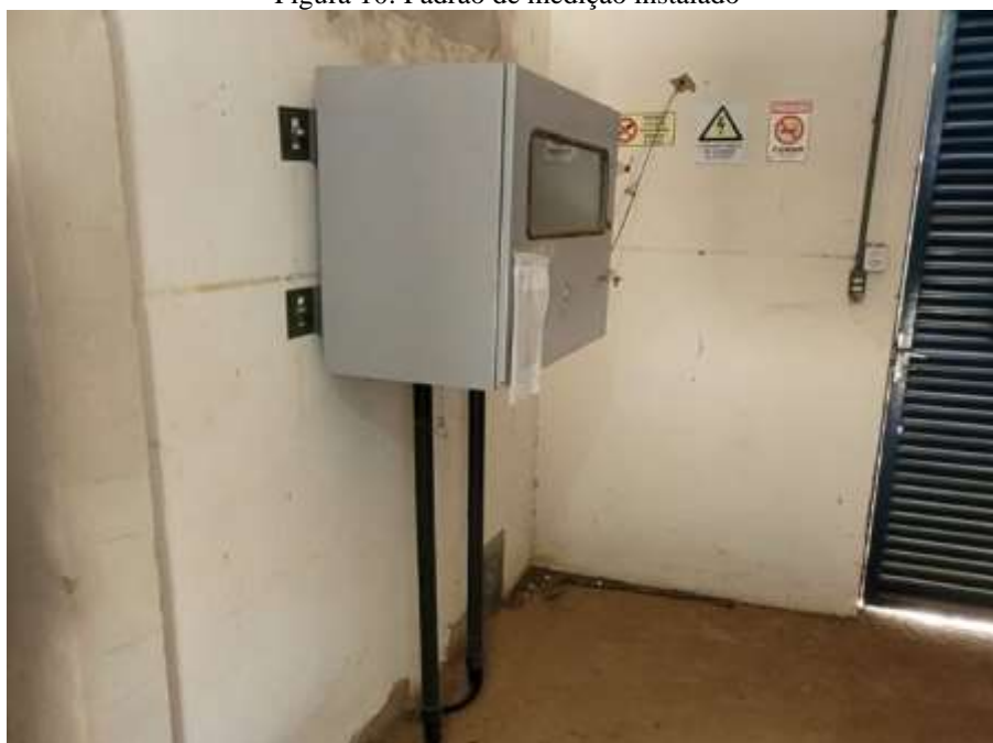
Figura 10: Padrão de medição instalado
