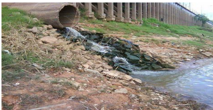
Figura 4 – Lançamento de esgoto diretamente no Rio Tocantins
